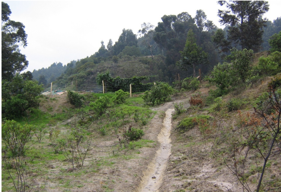
Fotografía No. 5. Se observa al fondo la cerca de cerramiento construida con poste de madera y alambrea de púa y las actividades empradización y revegetalización.
